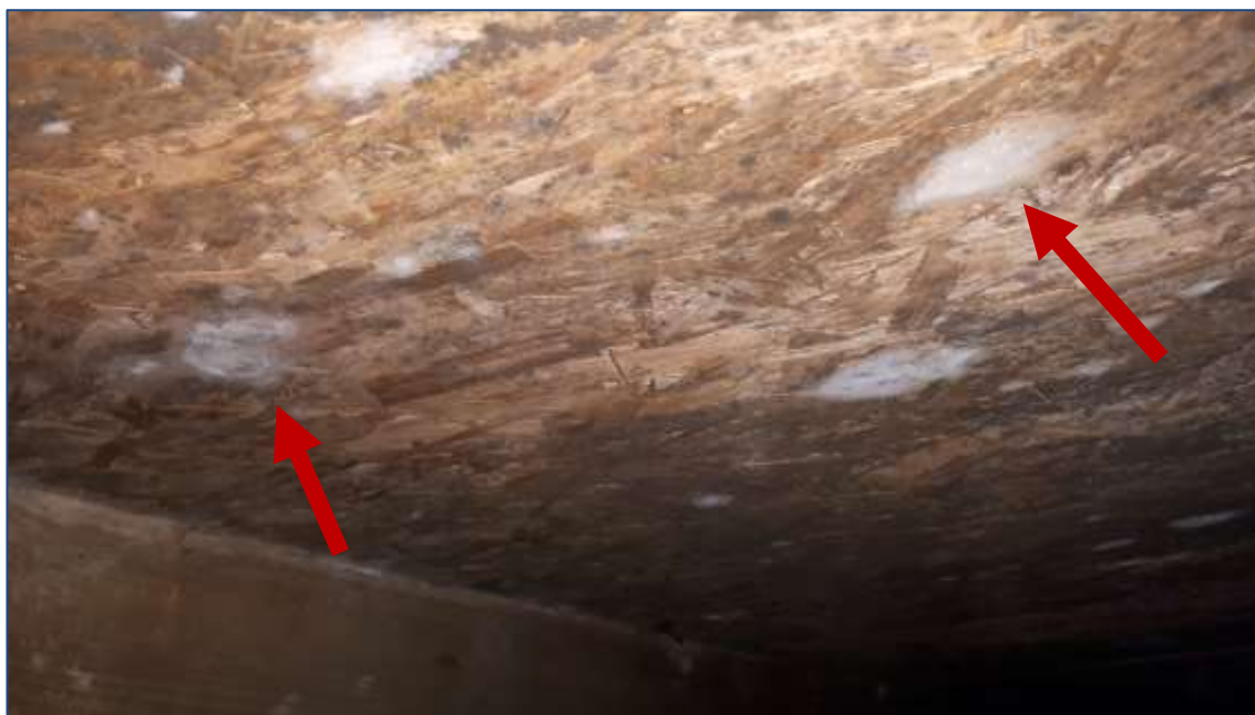
Foto č. 2 – Vrchní plášť střechy z OSB desek je uložen přímo na podélných dřevěných prvcích. Rozšířený výskyt plísní.
