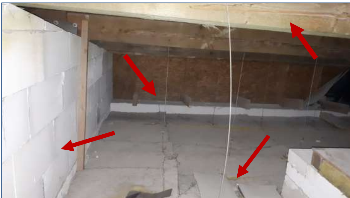
Foto č. 1 – Dělicí stěny z porobetonu bez tepelné izolace (značné tepelné mosty). Tepelná izolace z MW na SDK roštu je nesouvislá, s mezerami. V přechodu svislé a vodorovné části střechy je vzduchová mezera přerušena.
